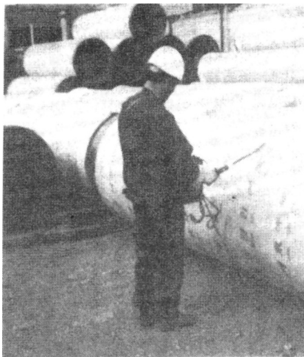
사진 : 외면도장 공장 절연검사
