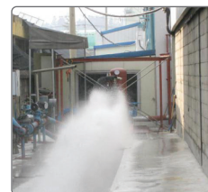
케비테이션 저감 제수밸브 설치 전 방류사진
