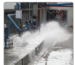
케비테이션 저감 제수밸브 설치 후 방류사진
